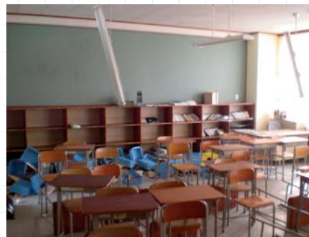
児童用ロッカーからは物が飛び出し、天井から蛍光灯が落ちた。校舎内も大きな被害を受けた。
